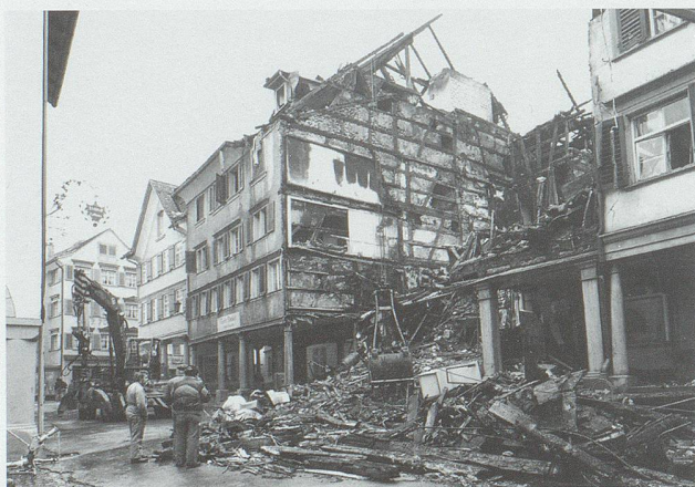
Lichtensteig, Hauptgasse 5–11. Photogrammetrische Aufnahme des Kulturgüterschutzes 1972 und Fotografie nach dem Brand vom 28. Februar 1984 (Plan und Foto: Stadtarchiv Lichtensteig).
