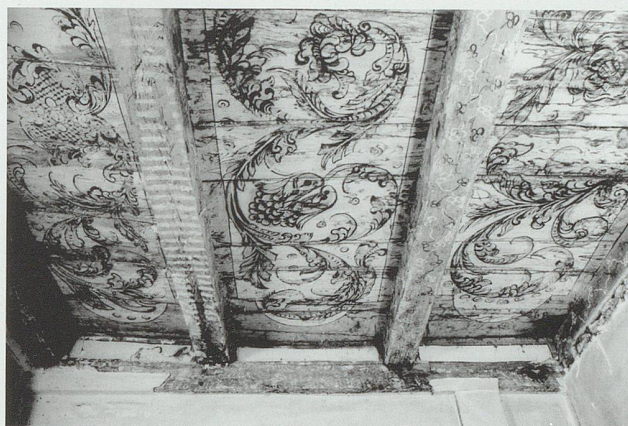
Rheineck, Alte Krone: renovierte Fassade und renovationsbedürftige Malereien. (Bilder kant. Denkmalpflege)
