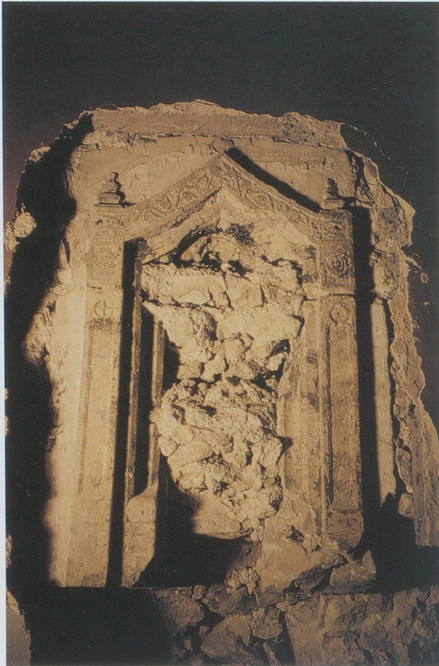
Abb. 17: Jona, Pfarrkirche. Sakramentsnische bei der Auffindung und nach der Restaurierung. (Bild KASG)
