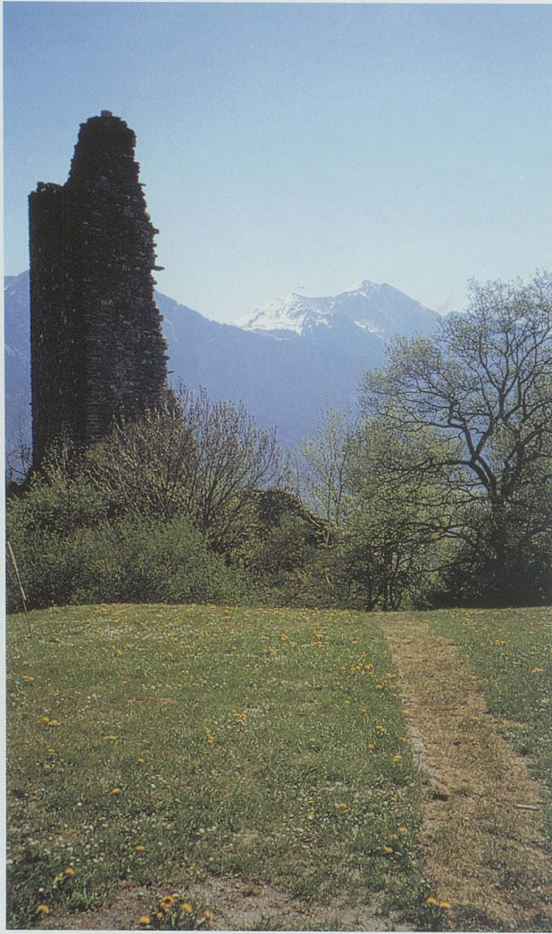
Abb. 14: Gut gemeint. Schlecht gemacht. Baggerschlitz auf der Ruine Freudenberg bei Bad Ragaz: Hier wäre 2003 eine archäologische Begleitung zwingend notwendig gewesen! Der Graben ist bereits geschlossen (heller Streifen rechts). (Bild KASG)
