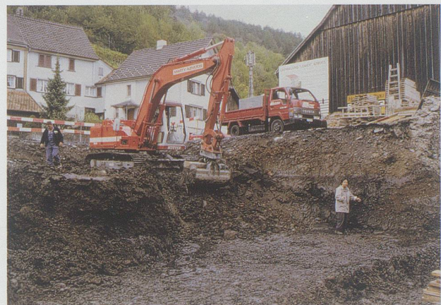
Abb. 20: Verlust von Geschichte: Der Bagger zerstört innert Stunden die Quellen zu 2000 Jahren Geschichte. Wartau-Azmoos, Überbauung Löwen Azmoos. Maja Suennderhauf, Konservatorin Regionalmuseum Schlangenhaus Werdenberg bei der Notdokumentation von frühmittelalterlichen Siedlungsresten. (Bild KASG)
