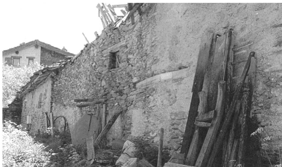
Unordnung und Zerfall im Dorf, im Hintergrund Giebel eines renovierten Hauses.
