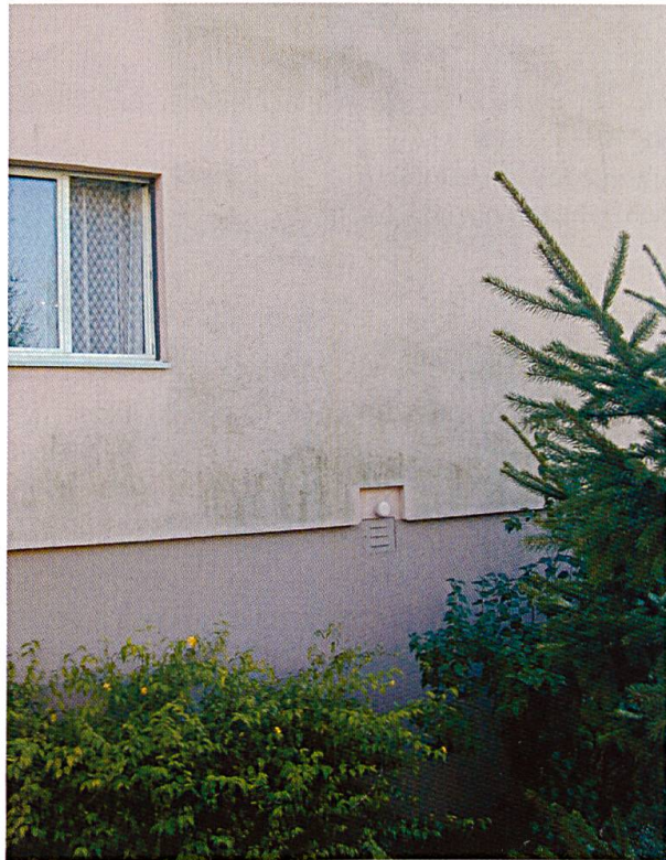
Abbildung 8: Fassadenbewuchs einer verputzten Aussenwärmedämmung. Bild M. Nay.
