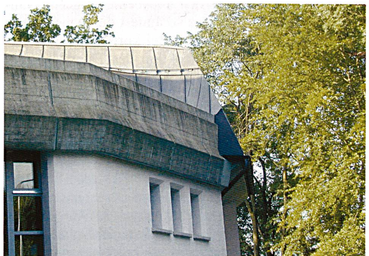
Abbildung 9: Dem Wetter ausgesetztes Betonelement mit Bewuchs. Bild M. Nay.
