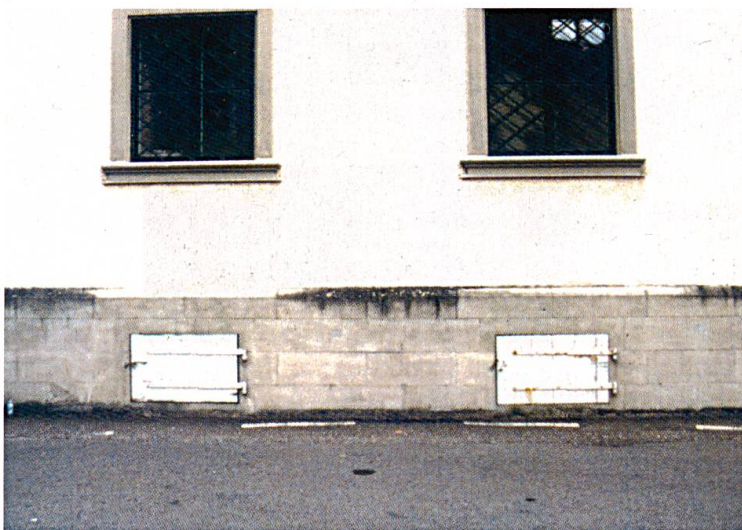
Abbildung 5: Der kleine Gesimsvorsprung der Fenster verhindert «schwarzes» Pilz- und Algenwachstum auf dem Mauersockel.
