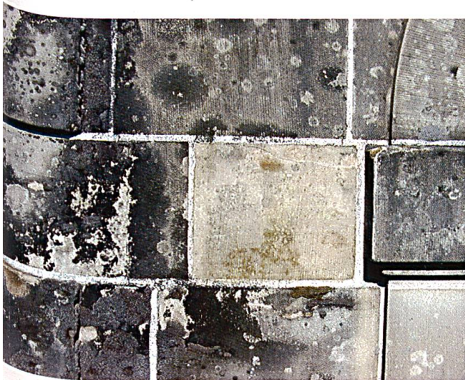
Abbildung 7: Reinigungsprobe vor/nach Bewuchsentfernung an der Fassade von Abbildung 6.
