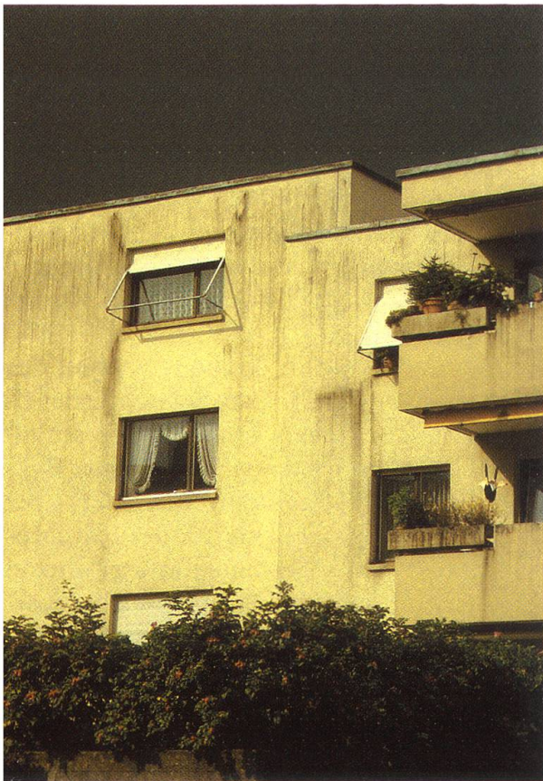
Abbildung 8: Bewuchs an verputzter Aussenwärmendämmung.
