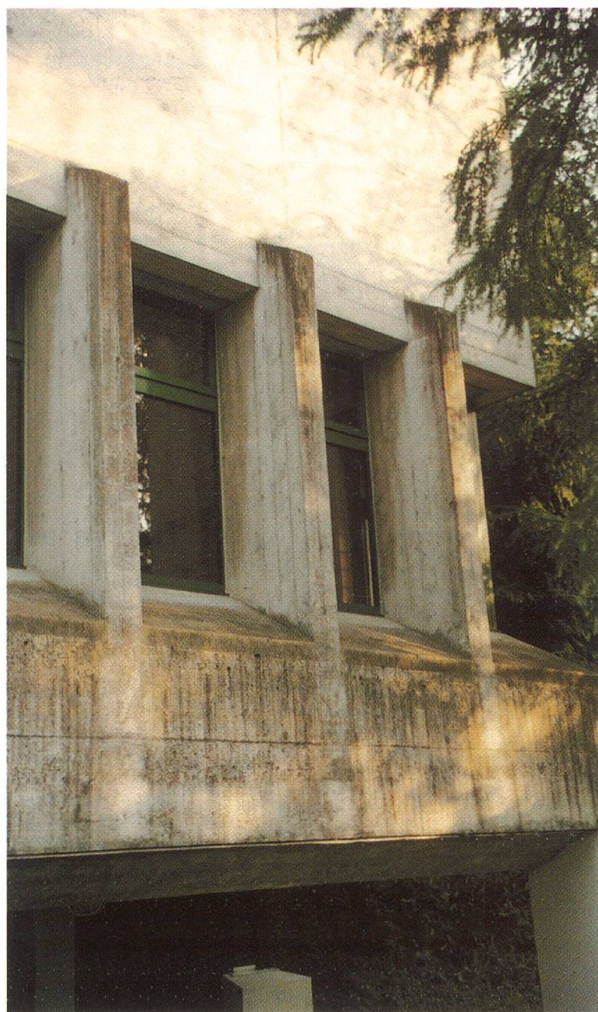
Abbildung 7: Bewuchs der gleichen Turnhalle 12 Jahre später.
