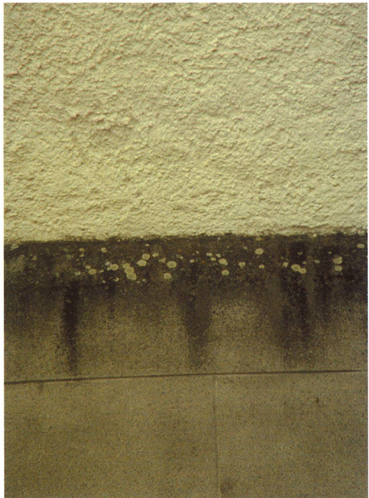
Abbildung 5: Bewuchs an Mauersockel.
