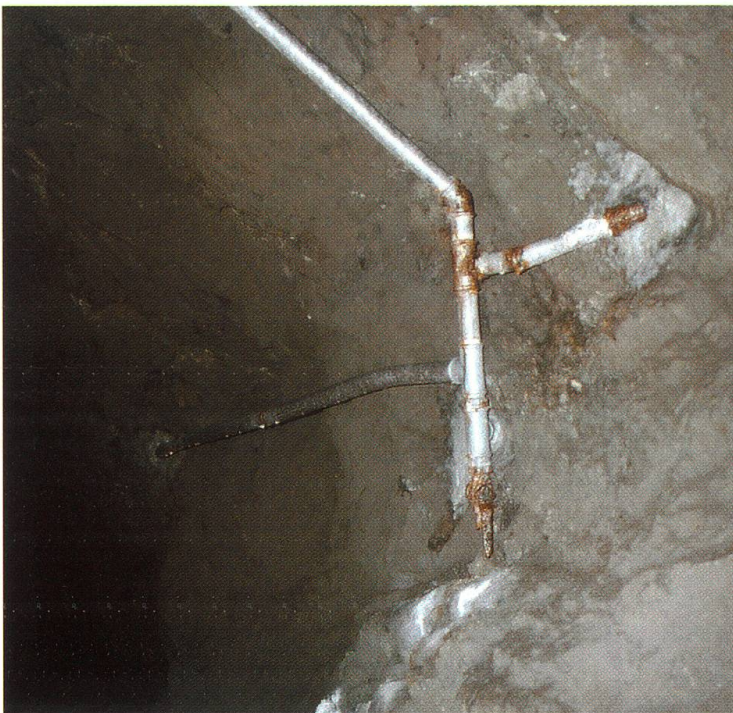
Abbildung 11: Gasfassung im Montpertjörisstollen.
