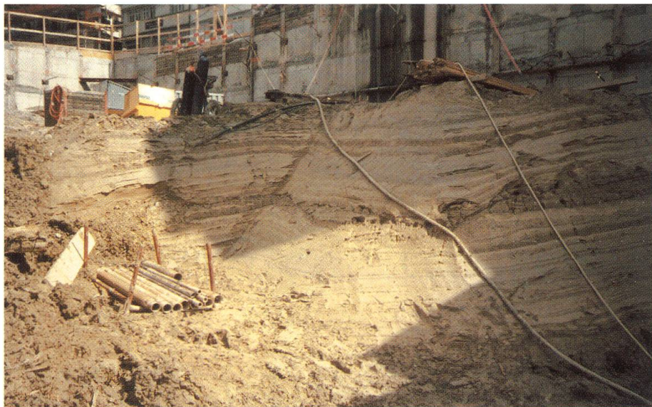
Abbildung 17: Baugrube der Kantonalbank Herisau. Bänder-tonartige Feinschichten von Silt und Ton belegen den eiszeitlichen Stausee mit Spiegelhöhe um 770 m im Feuerthalen-Stadium.
