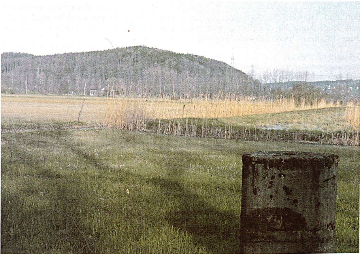
Abbildung 4: Die weit aus dem Boden ragenden Schachtdeckel zeugen von den Bodensackungen nach der Entwässerung.
