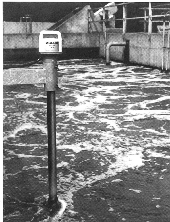
Abb. 6: Art des Einsatzes von Redox- und Sauerstoffsonde in einem Belüftungsbecken
