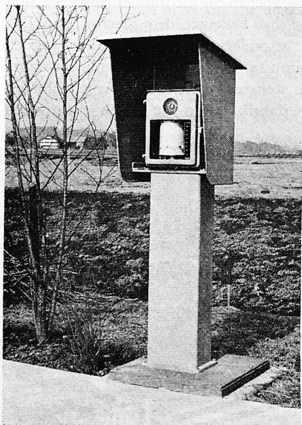
Registrierender Mengenmesser in einer Kläranlage
