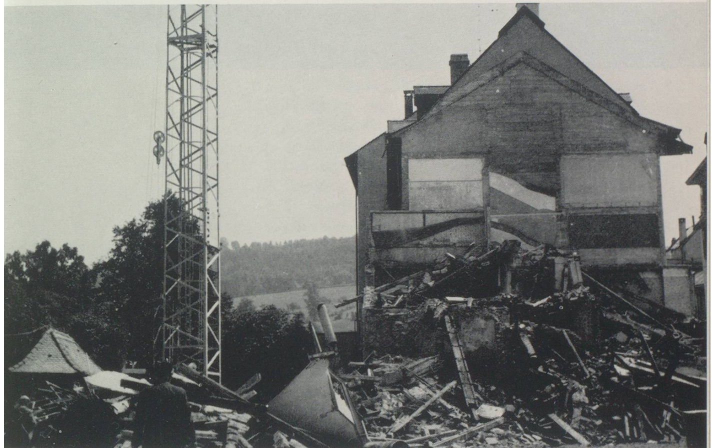
Das alte Haus Weißhaar wird abgebrochen, um den ansteigenden Verkehrstrom Marktplatz-Brühltor besseren Abfluß zu sichern
