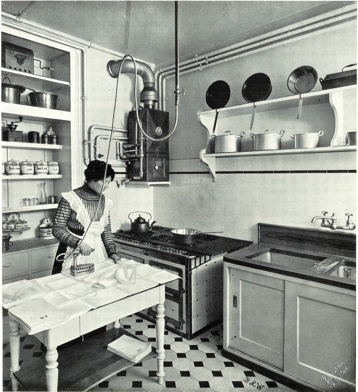
Ausgeführte moderne Küche, bestehend aus Doppelpültrog, Mott-Ausguß, Plättli-Gasherd, Bügeleinrichtung, ferner Gasautomat, welcher die Küche, sowie das angrenzende Bad- und Toilettenzimmer mit Warmwasser speist.
