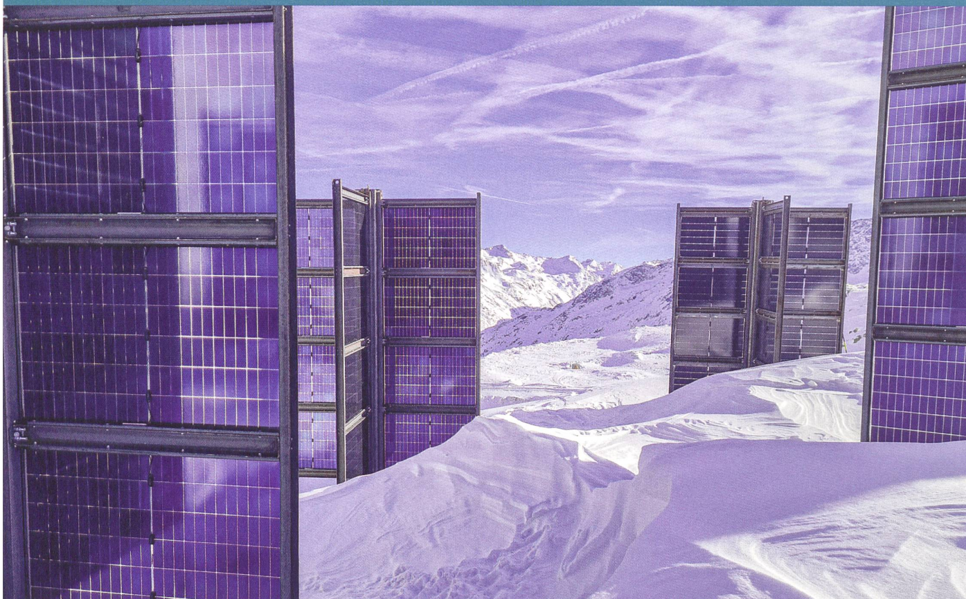
Installation Helioplant sur le site de la station de ski de Sölden, en Autriche.
