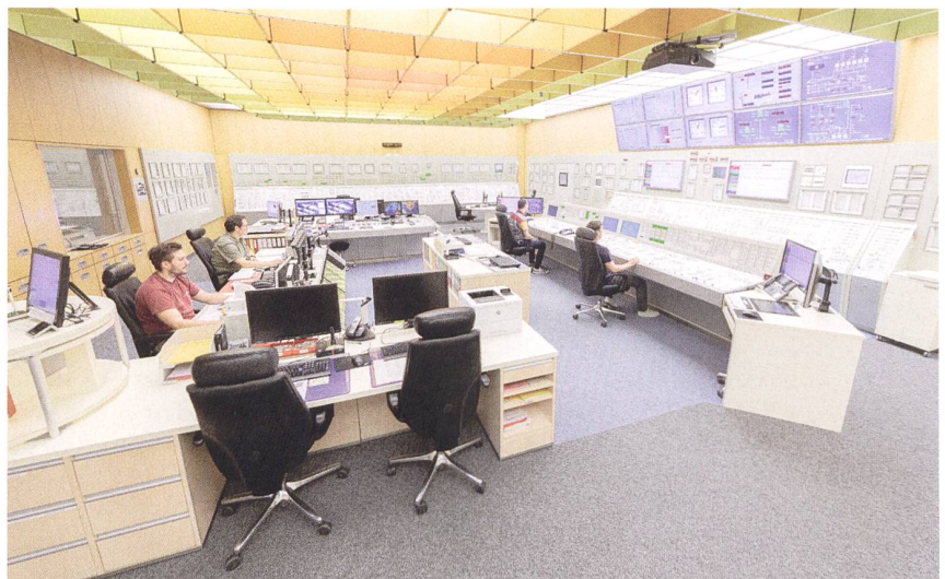
Steuerzentrale des KKW Gösgen.
