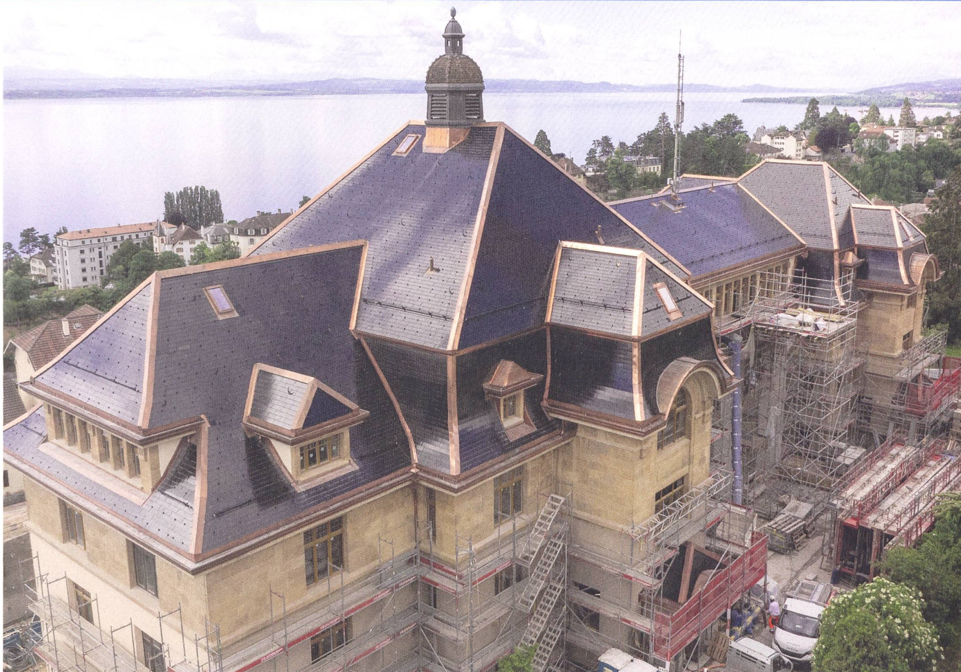
Des tuiles solaires ont été installées sur l'ensemble du toit du collège des Parcs, à Neuchâtel.
