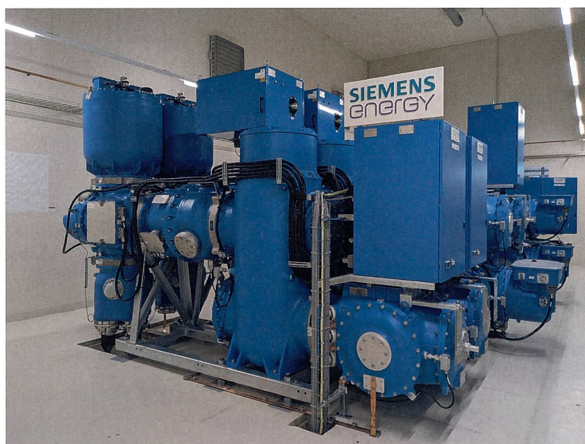
Bild 2 BlueGIS 145 kV im Unterwerk Uptown Basel.
