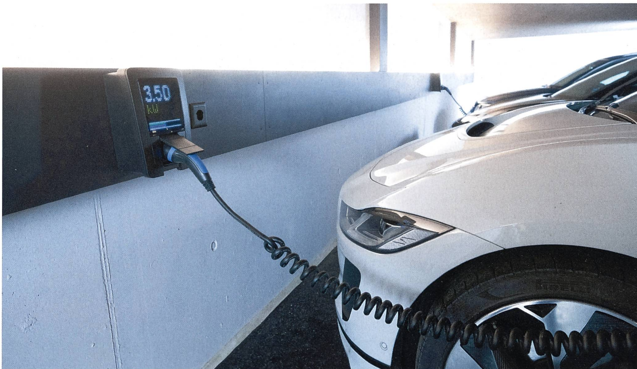
Pico-Ladestationen in der Einstellhalle.
