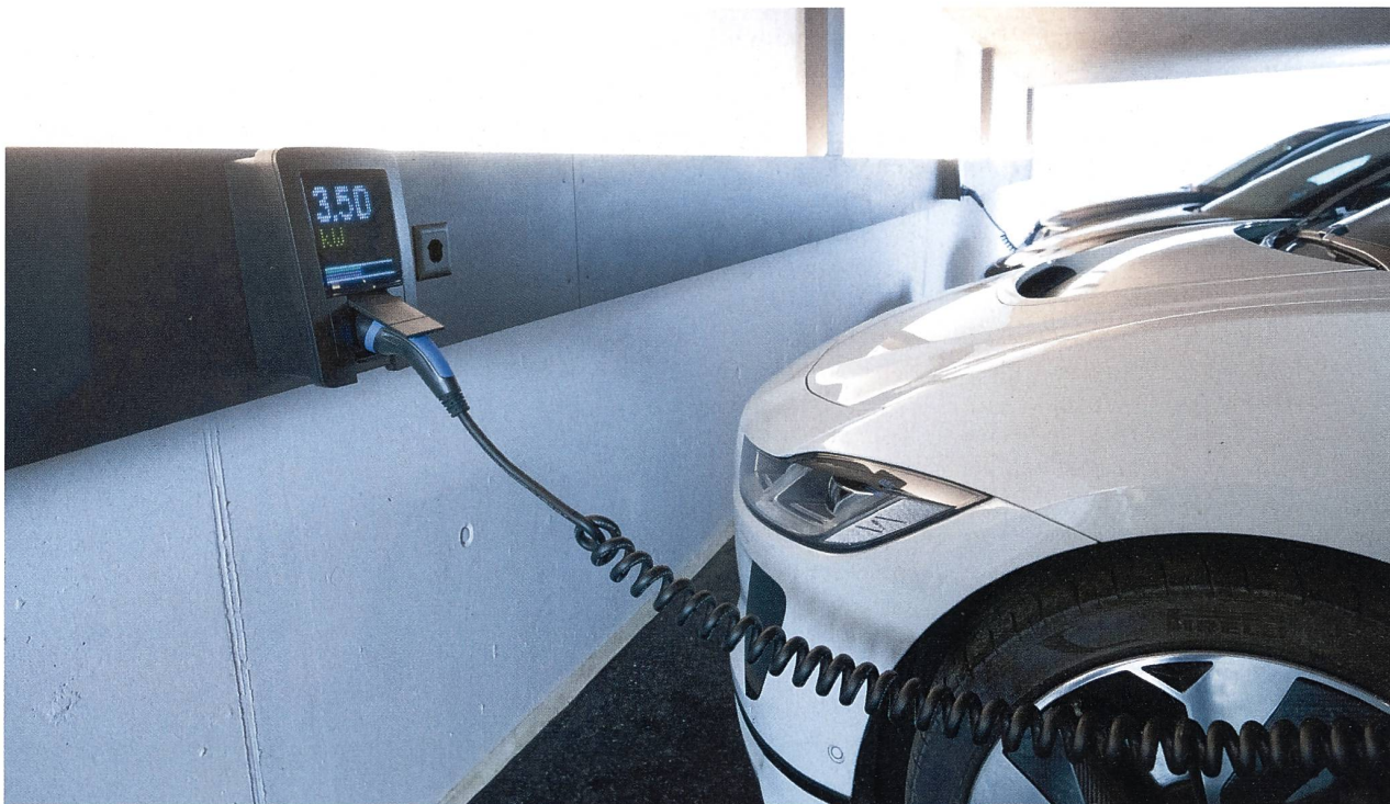
Pico-Ladestationen in der Einstellhalle.
