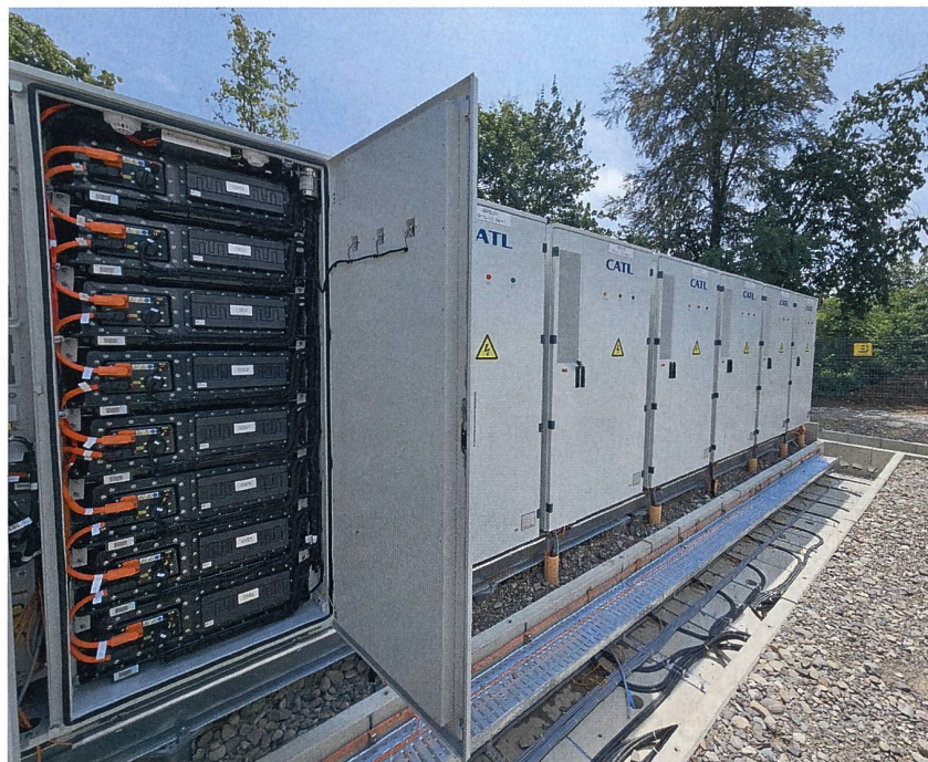
Das System mit einer Speicherkapazität von 10 MWh baut auf der Cube-Technologie auf.
