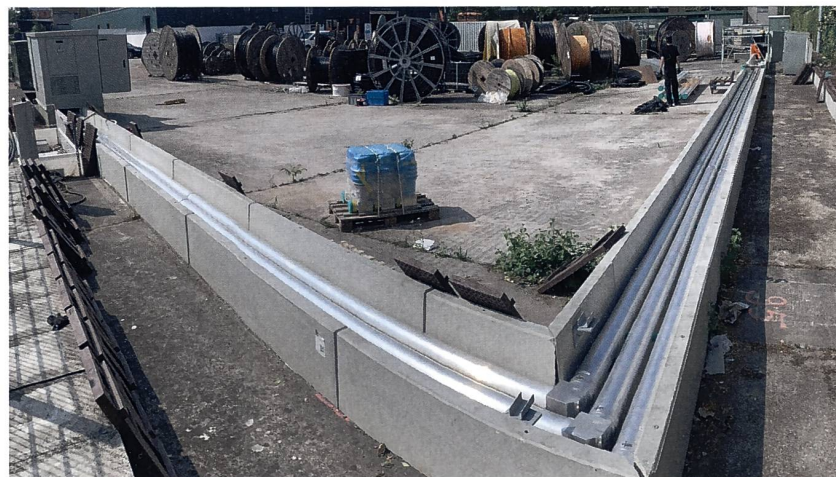
Figure 2 Câble à air comprimé moyenne tension (36 kV) avec trois phases juxtaposées, posé dans un canal de câbles.
