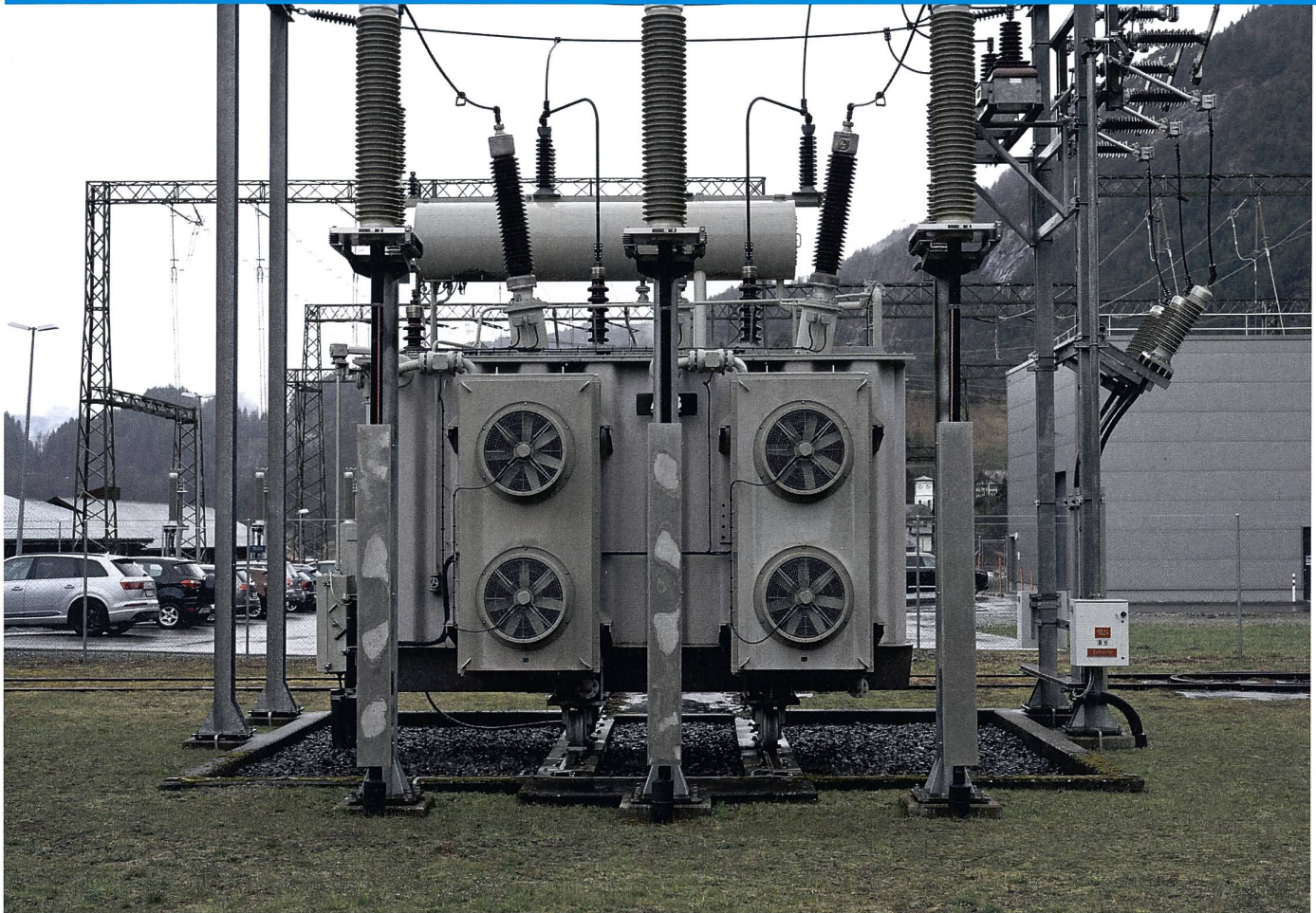
Hochspannungs-Transformator in Innertkirchen.
