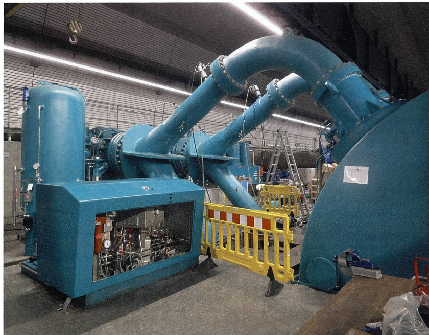
Figure 1 Répartiteur du groupe 3 de la centrale de Veytaux I instrumenté durant la campagne de mesure de performances par la méthode thermodynamique.
