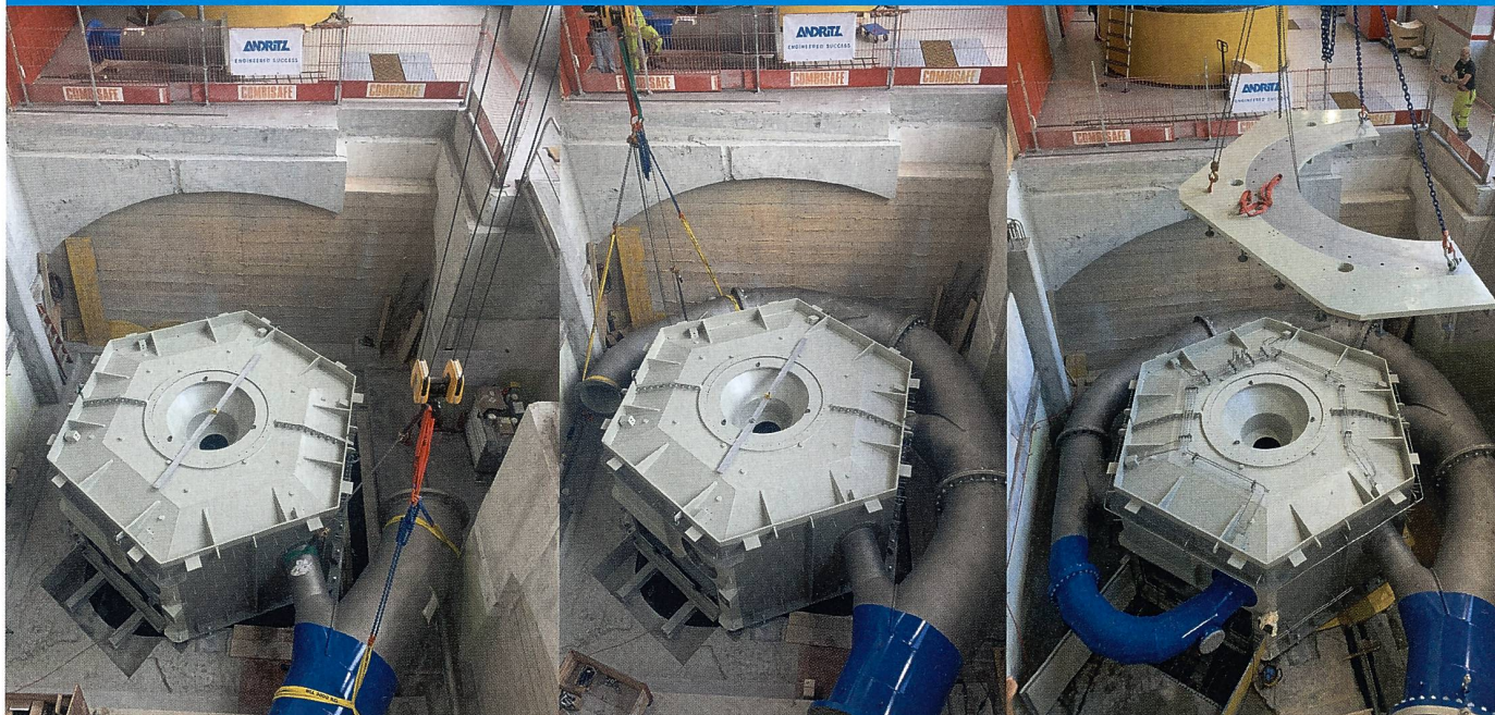
Nouvelle turbine Pelton de la centrale de Sembran-cher en cours de montage dans le bâtiment existant.
