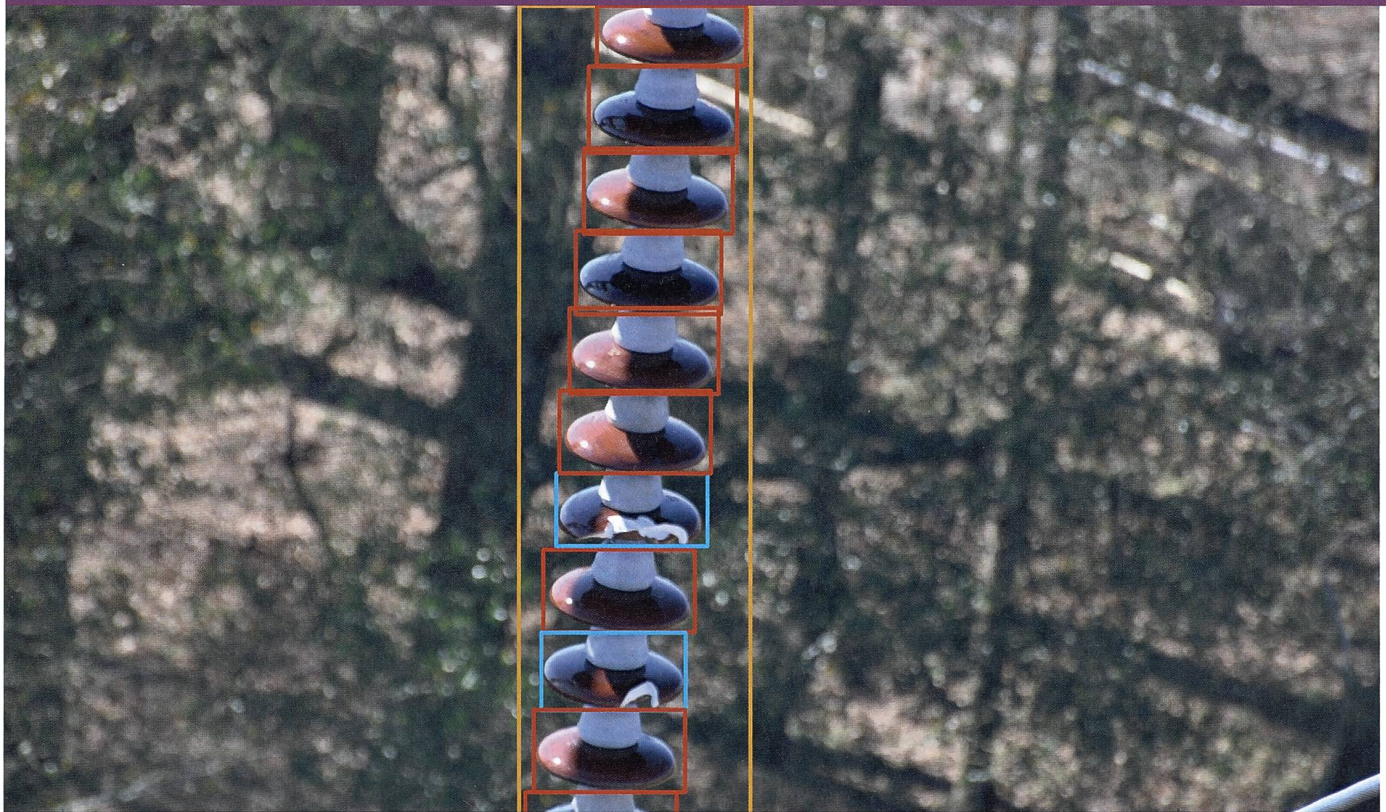
Photo d'un isolateur, prise par un drone puis analysée. Les disques défectueux sont encadrés en bleu.
