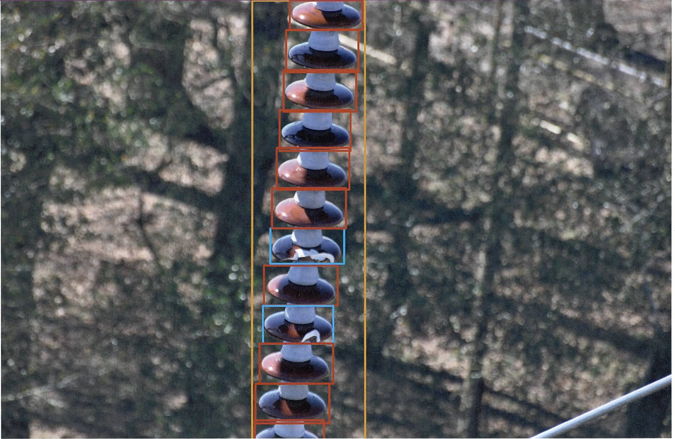
Ausgewertete Drohnen- aufnahmen von Isolato- ren. Fehlerhafte Scheiben sind blau eingerahmt.
