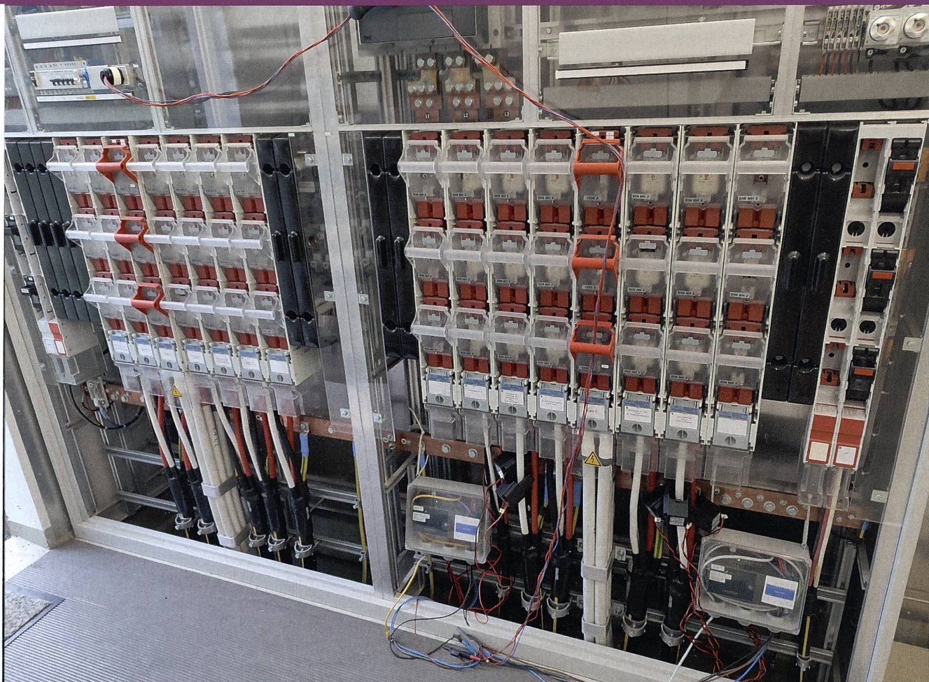
PQ-Messungen in einer Trafostation.
