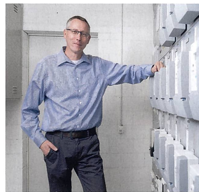
Smart-Meter-Lösung von CKW.
