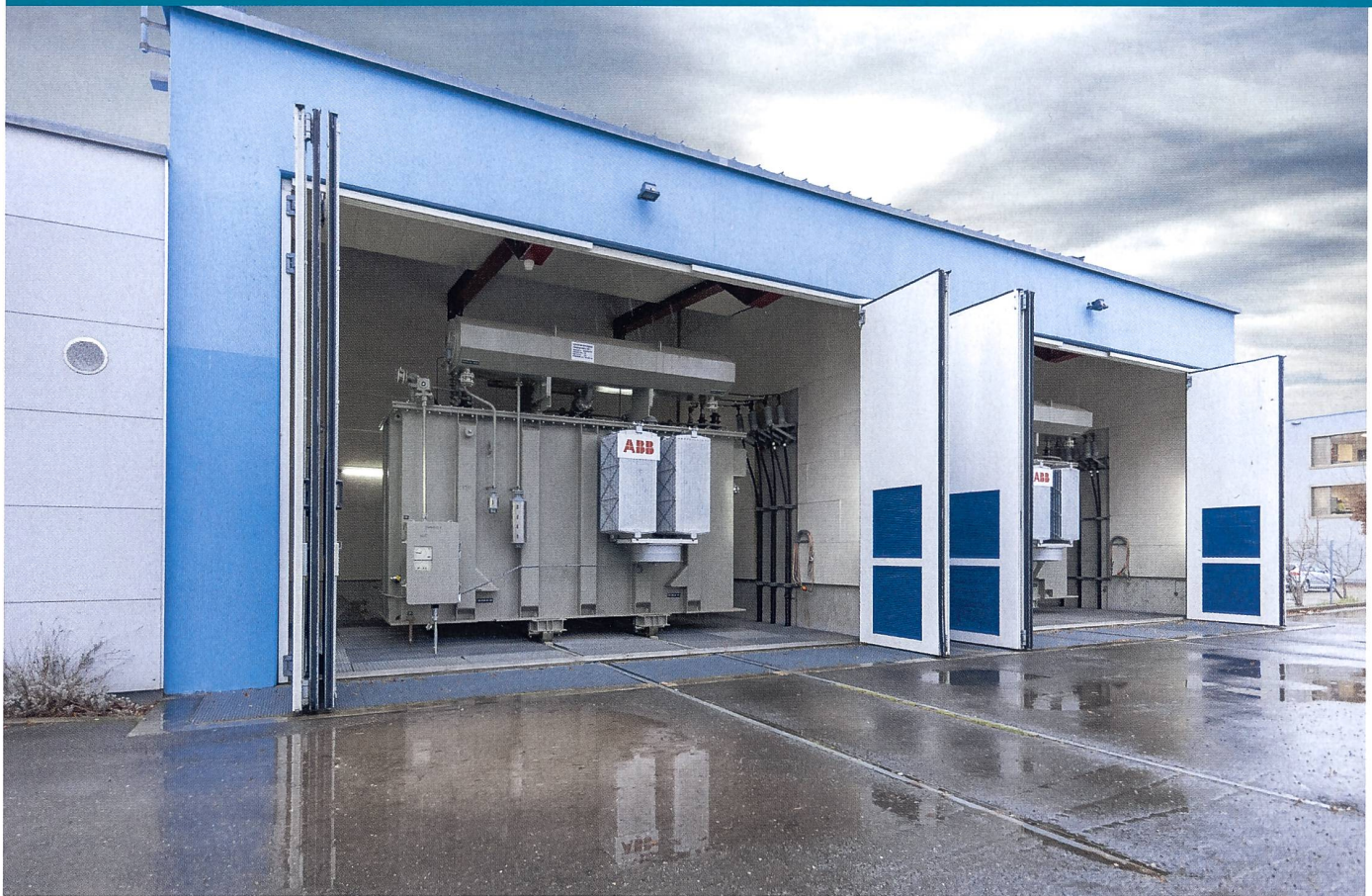
HS/MS-Transformatoren (25 MVA) mit dynamischer Regelung der Sekundärspannung.
