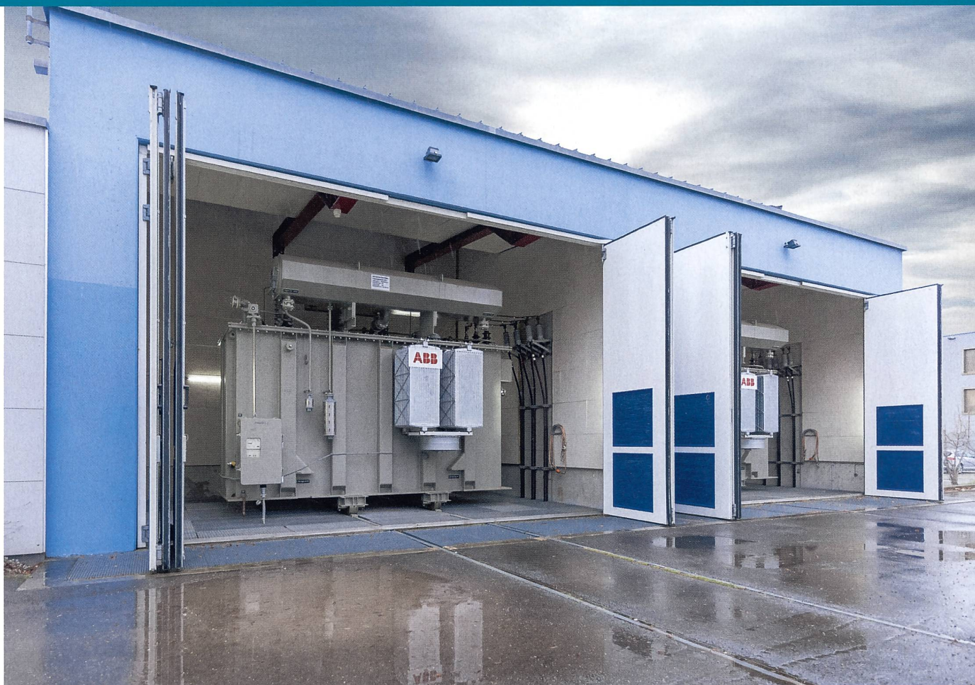
Transformateurs HT/MT de 25 MVA avec régulation dynamique de la tension secondaire.
