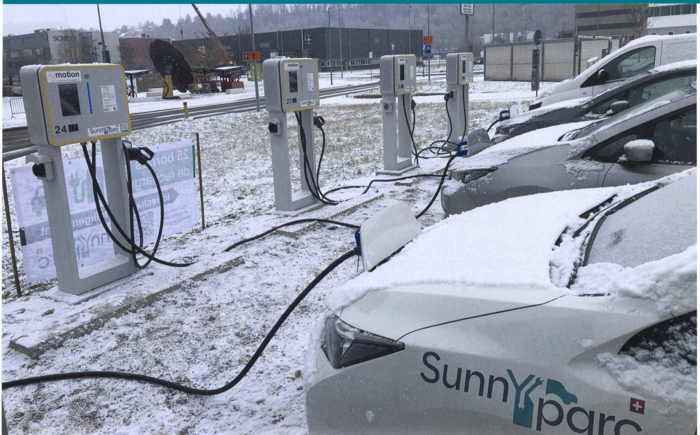
Décharge V2G simultanée de trois véhicules à 10 kW.
