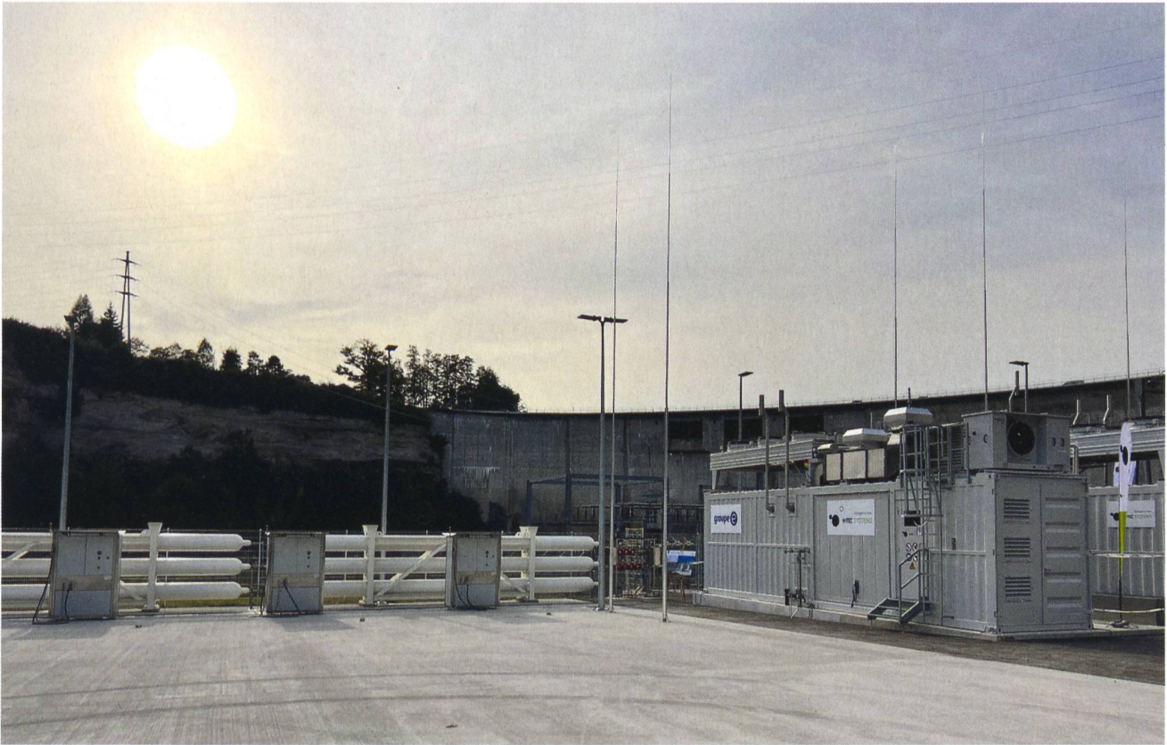
L'installation de production d'hydrogène avec les électrolyseurs (à droite) ainsi que les réservoirs et panneaux de remplissage (à gauche).
