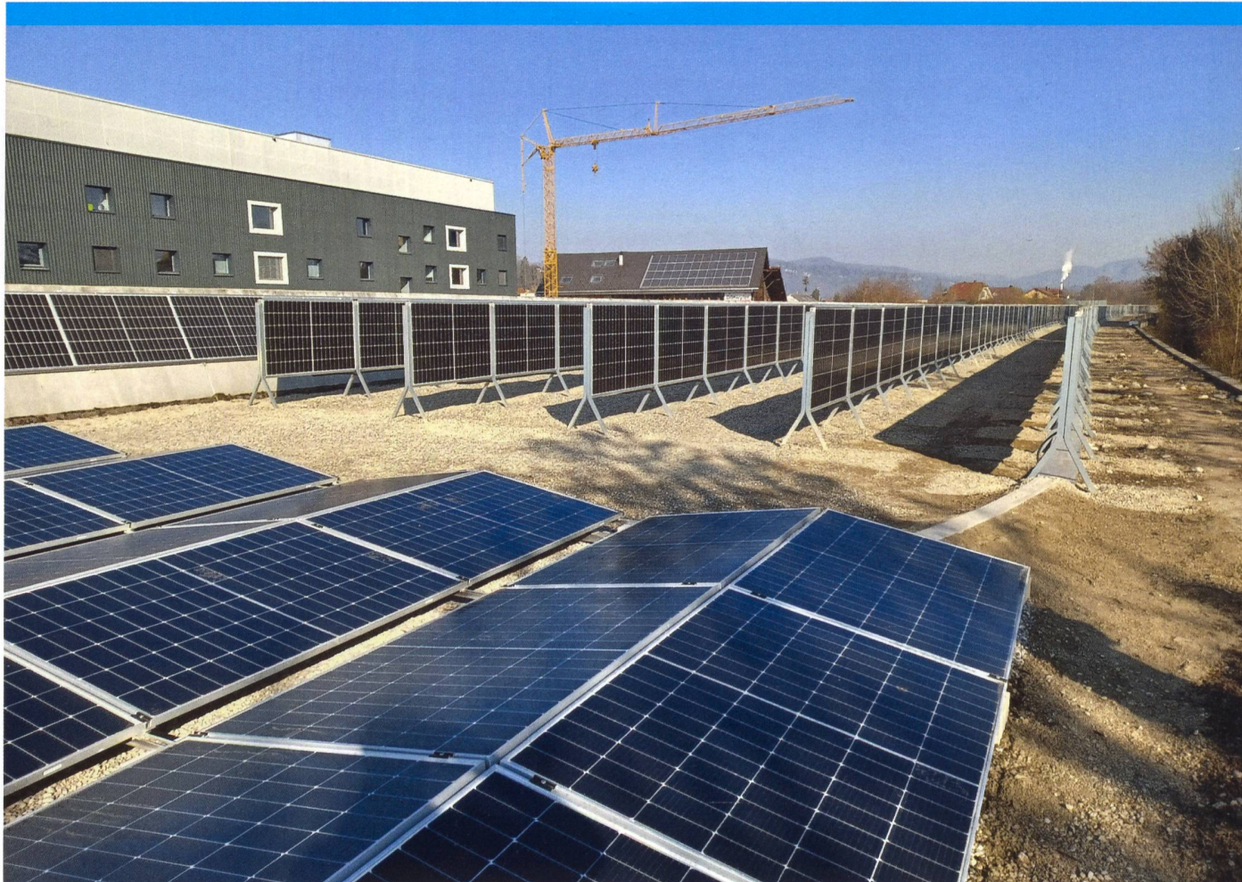
Zofingen: PV-Anlagen mit Lärmschutz und Biodiversität kombiniert.
