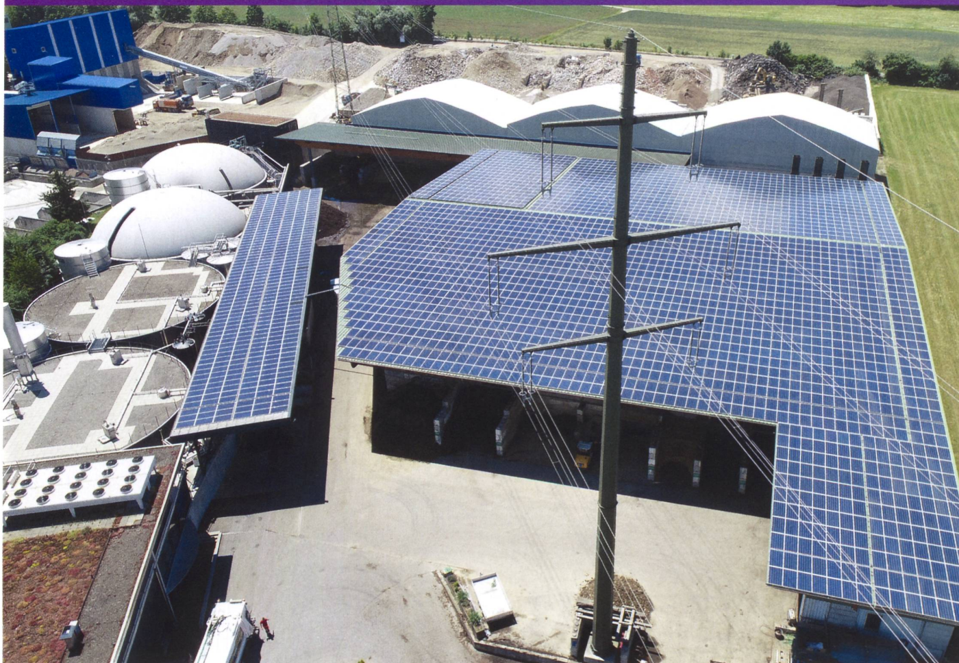
Eine PV-Anlage im Netz der AEW, bei der die Blindleistung geregelt wird, um das Netz zu stabilisieren.
