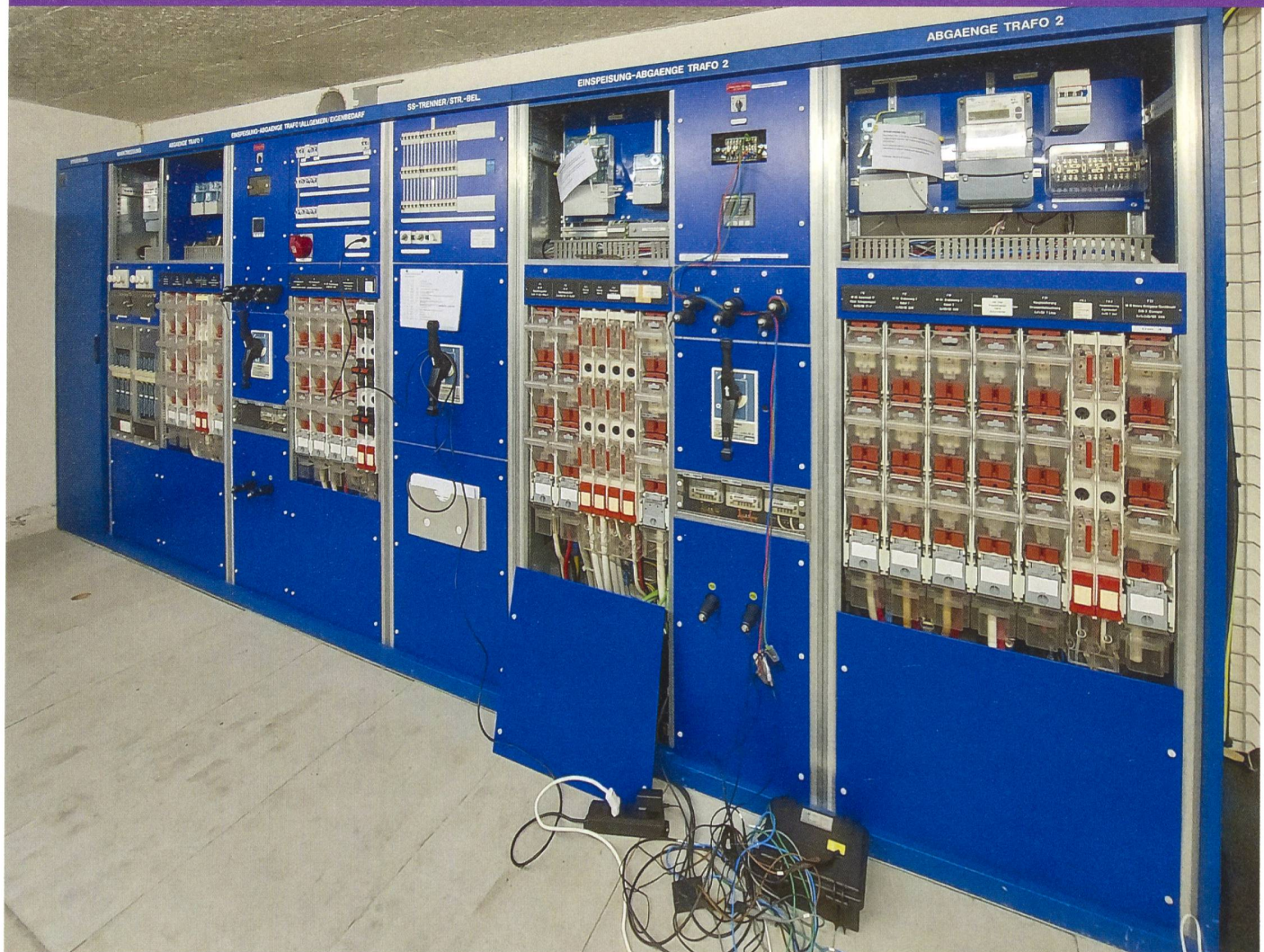
Messungen in einer Niederspannungs-Trafostation.
