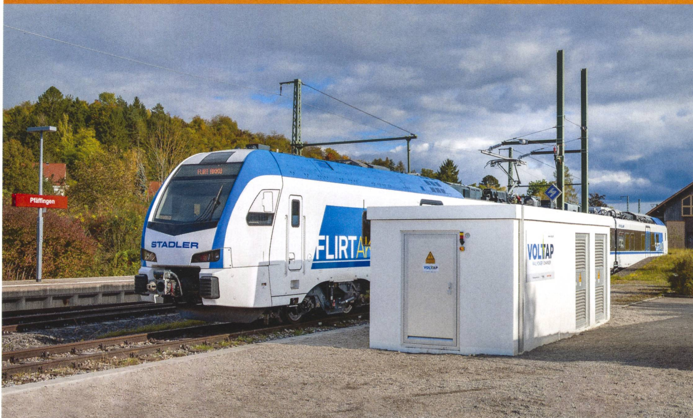
Prototyp der Voltap-Schnellladestation für Batteriezüge.
