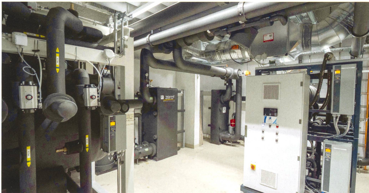
Centrale technique du réseau d'anergie au CO 2 réalisé sur le site du campus Energypolis, à Sion.
