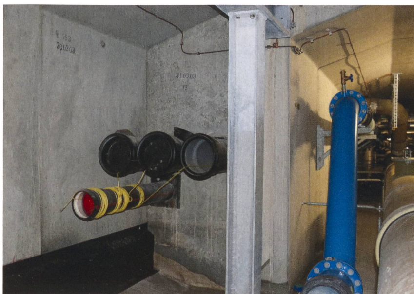
Die Kabel der neuen 220-kV-Leitungen verlaufen im Uetlibergtunnel unter der Fahrbahn. Sie werden in bereits erstellte Rohrböcke neben dem Werkleitungskanal eingezogen.
