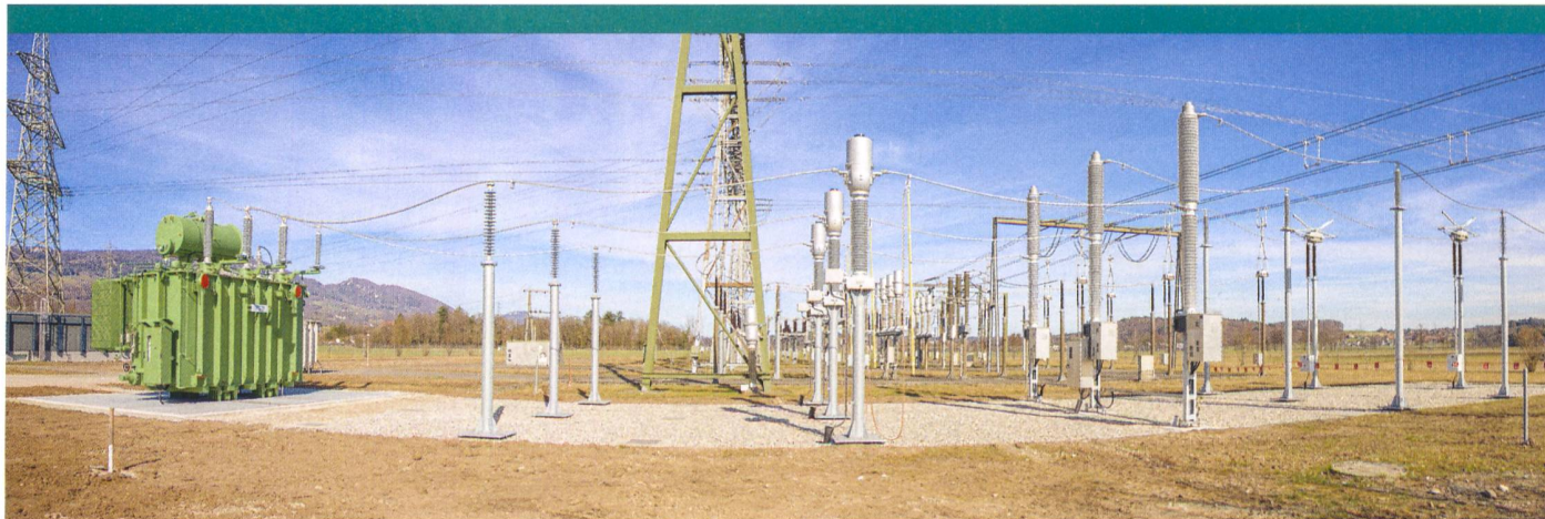
Installation mit Drosselspule, Kombiwandler und Leistungsschalter.
