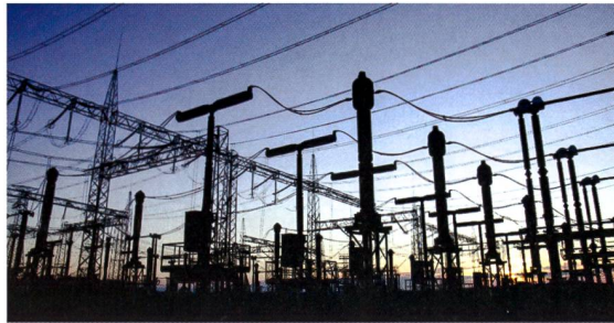
Umspannwerk mit Leistungsschaltern.
