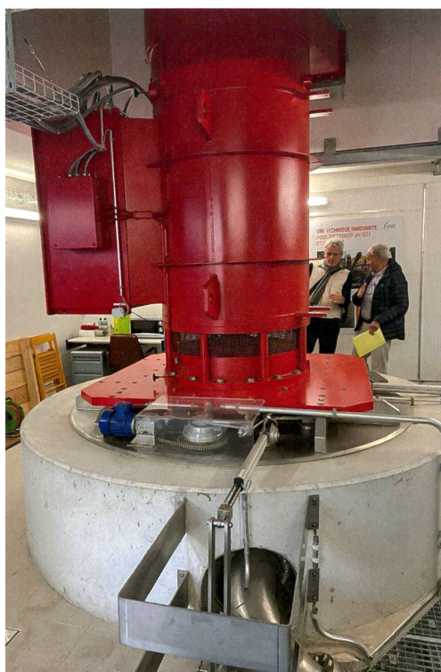
Dans les entrailles de la centrale hydraulique du Forestay à Rivaz.
