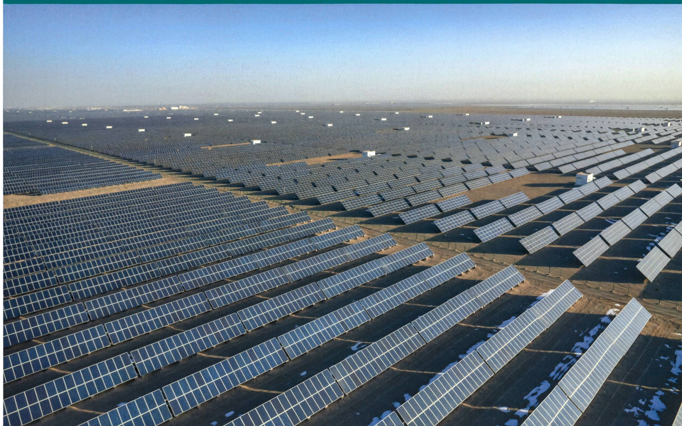
Centrale photovoltaïque à Dunhuang, en Chine.
