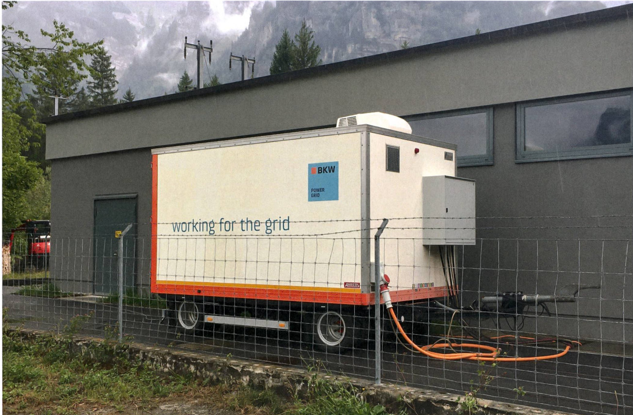
Mobile Rundsteueranlage vor der Unterstation Brienz.
