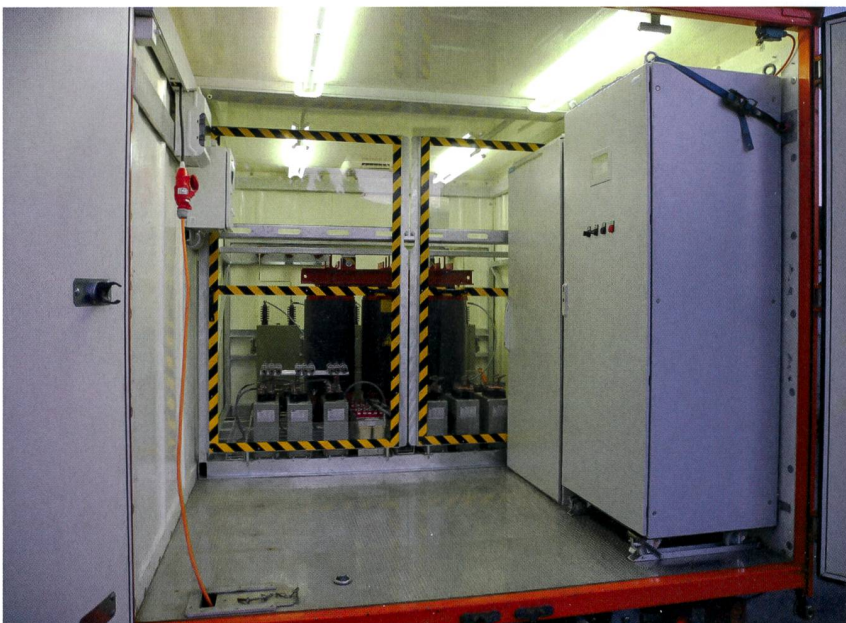
Bild 3 Das Innere der betriebsbereiten Rundsteueranlage.
