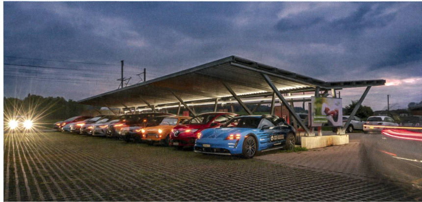
Le nouveau parc de stations de recharge, à la Luppmenstrasse à Fehrltorf.
