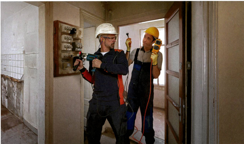
In alten Schaltgerätekombinationen ist oft Asbest enthalten.
