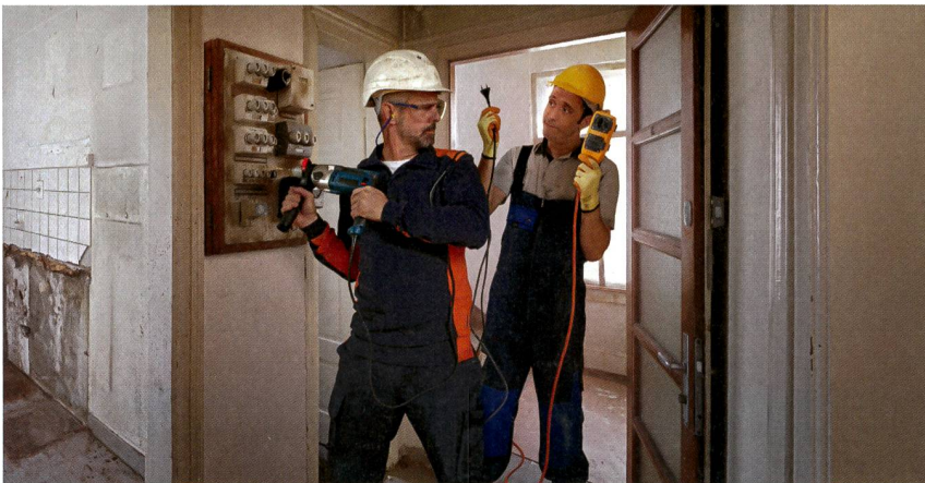
Les ensembles d'appareillage peuvent renfermer de l'amiante.
