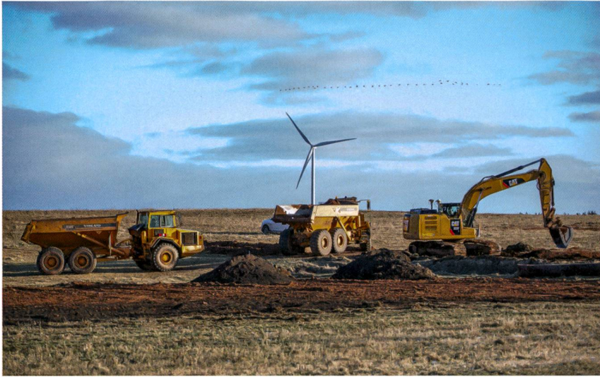
Bild 3 Baubeginn für das inselfähige Mikrogrid Slemon Park, P.E.I.
