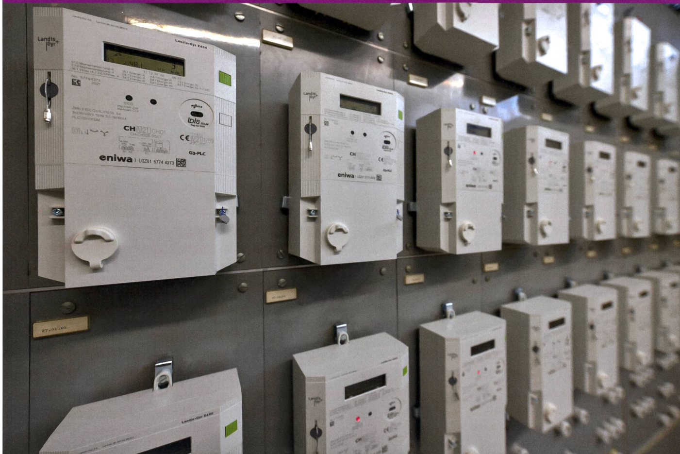
Smart Meter lösen die herkömmlichen Stromzähler ab (Symbolbild).
