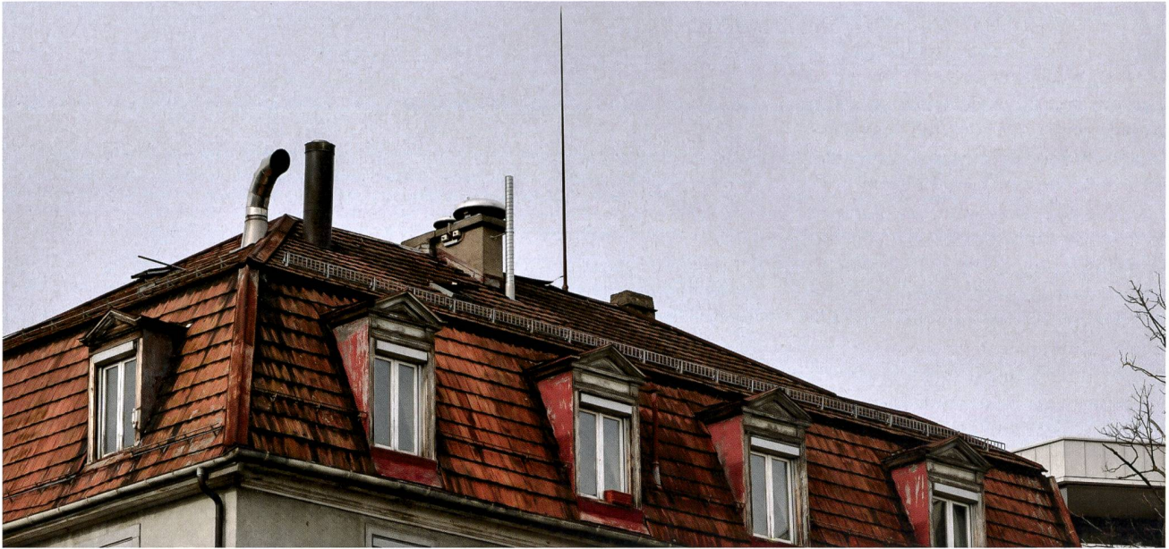
Protection extérieure contre la foudre sur un immeuble d'habitation à Zurich.
