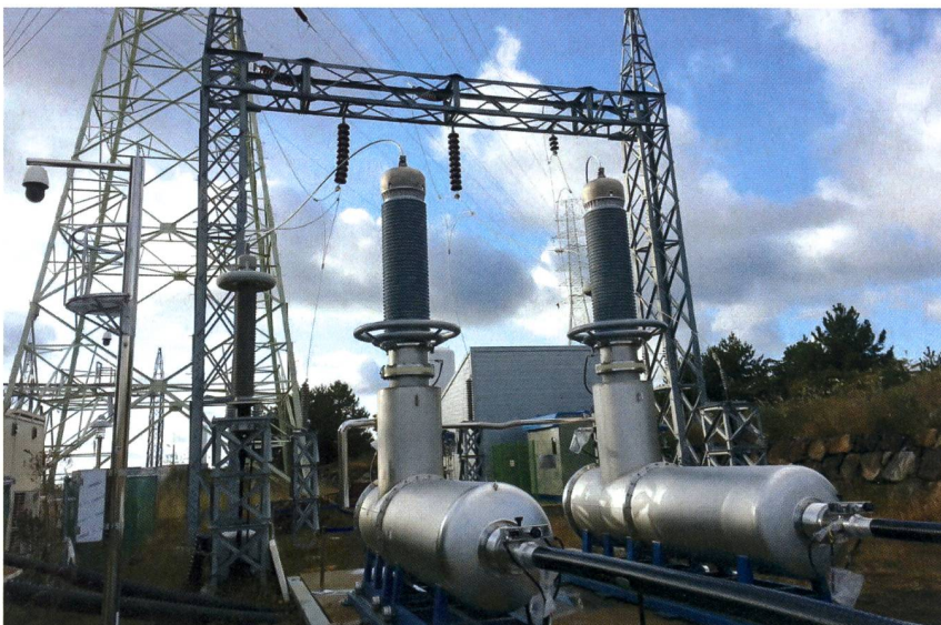
Endpunkt eines supraleitenden Gleichstromkabels mit 80 kV Spannung in Südkorea.
