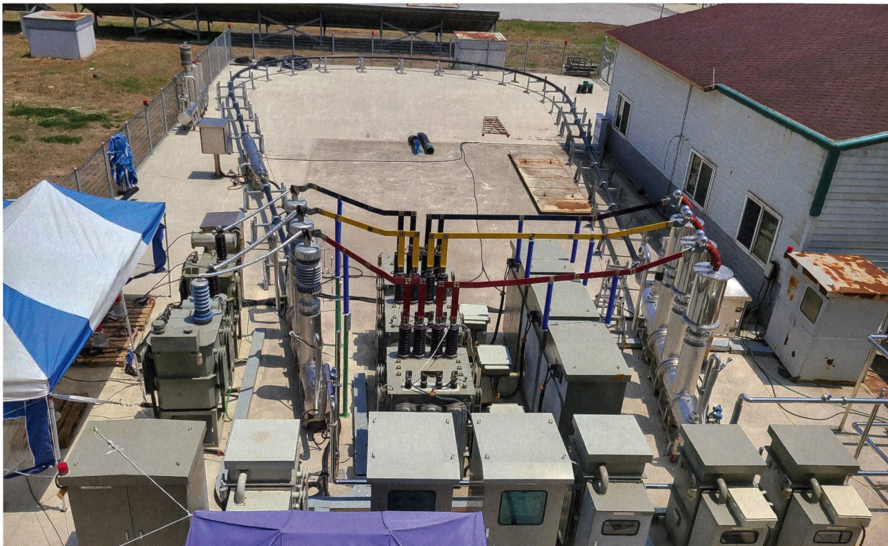
Typentest eines HTS-Kabels (23 kV 60 MVA) in Gochang.
