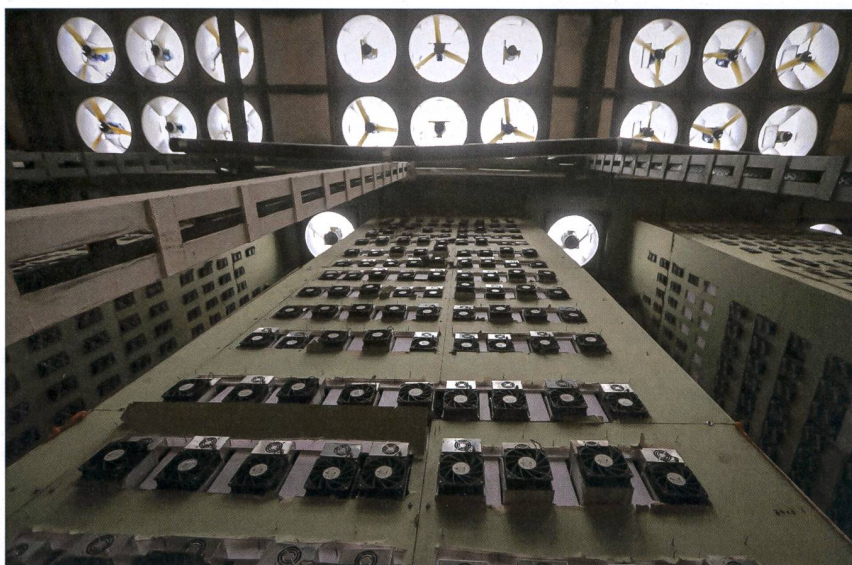
Innenansicht des Rechenzentrums der BTC KZ Crypto Mining Company bei der Stadt Ekibastus, Kasachstan, im November 2021.
