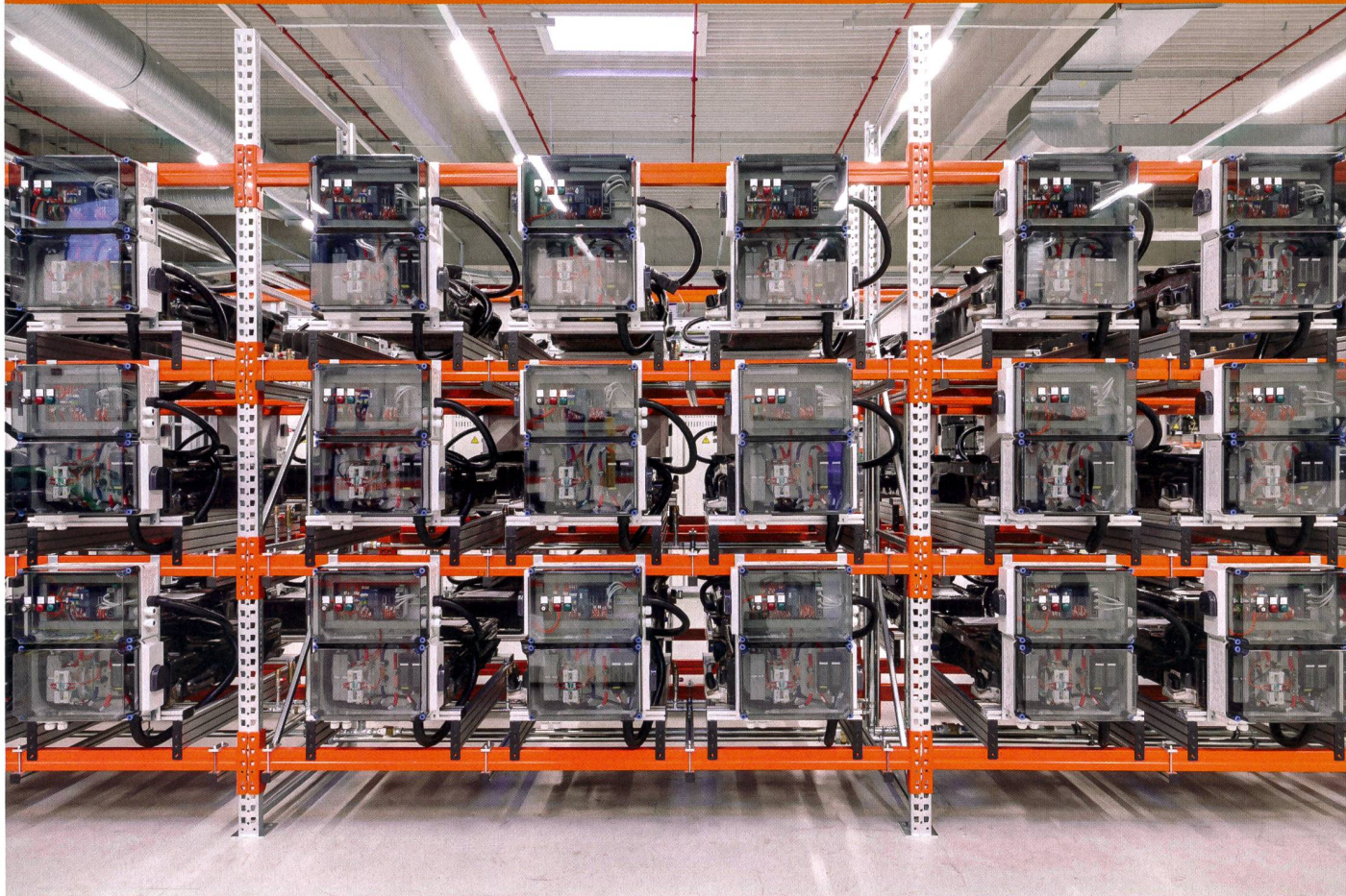
Lünen, Deutschland: der grösste 2 nd -Use-Batterie-speicher im Jahr 2016.
