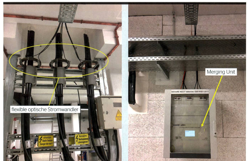
Bild 5 Montage-Setup des flexiblen optischen Stromwandlers im Unterwerk Châteland.
