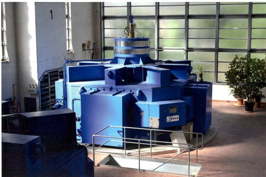
Einer der zwei zwanzigjährigen Generatoren der baskischen Firma Indar mit einer Nennleistung von 2,5 MVA in der Maschinenhalle.
